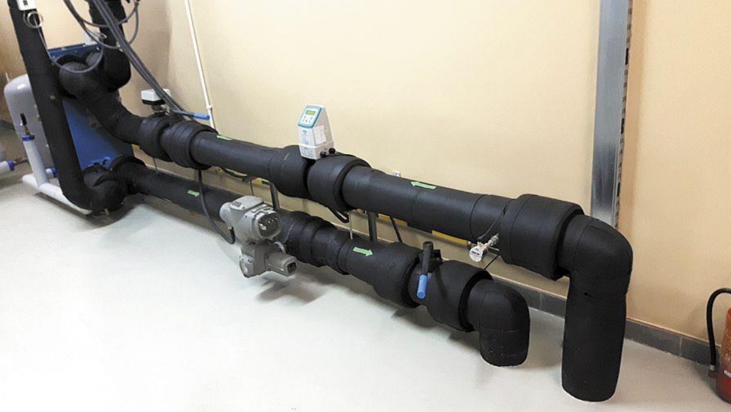
Fot. 2. Instalacja \varnothing 125 mm z PE do wymiennika pośredniego; fot. archiwum autora (J. Kozicki)
