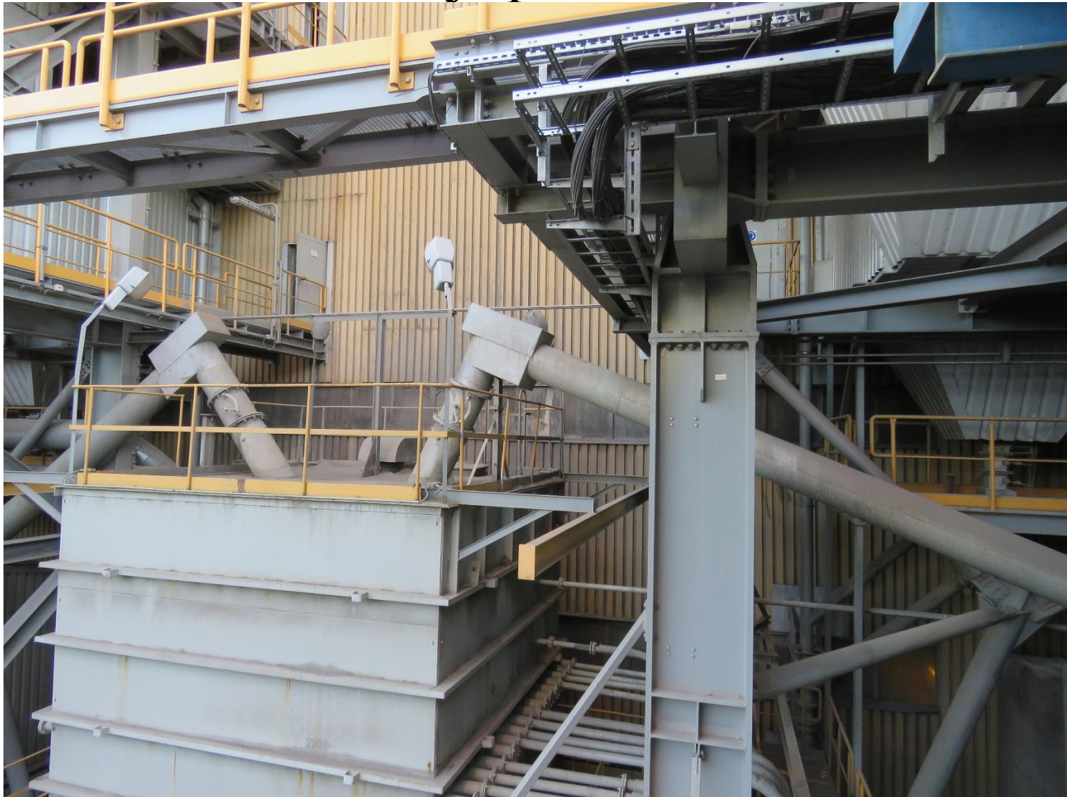
Górna część zbiornika pośredniego z odsysaniem powietrza
